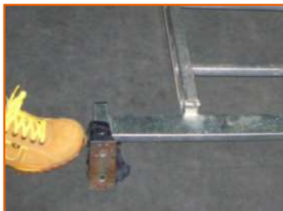
Dispositivi antisdrucchio della scala completamente usurati e inefficaci
