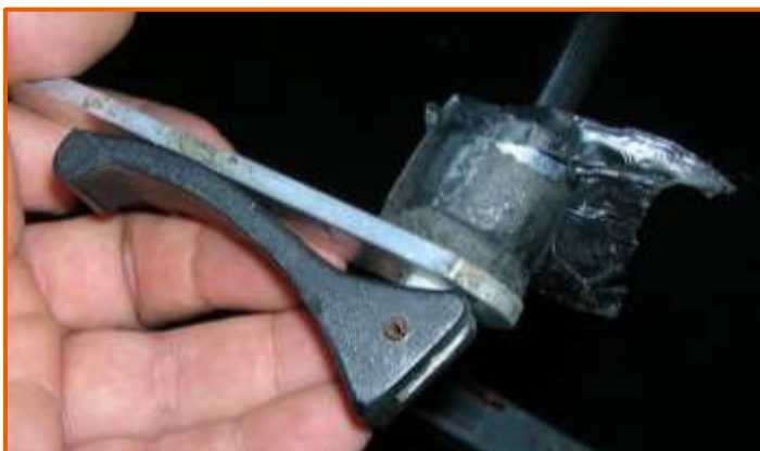
Dispositivo di sicurezza a tampone contro l'apertura della scala, usurato e manomesso con del nastro isolante al fine di ripristinarne inutilmente il funzionamento
